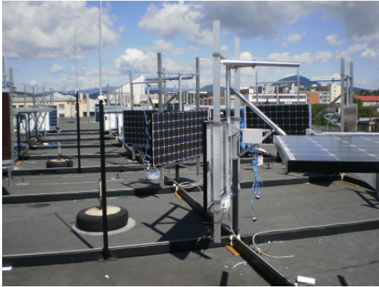
Obr. 3. Orientácia fotovoltaických panelov v smeroch juh, východ, západ a vodorovne.
