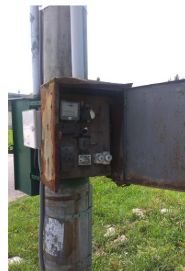
Obr. 2 Korózia rozvádzača, chýbajúca spodná časť skrine rozvádzača
