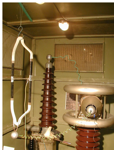
Obr. 2: Meranie čiastkových výbojov na cievke mimo drážky statora
